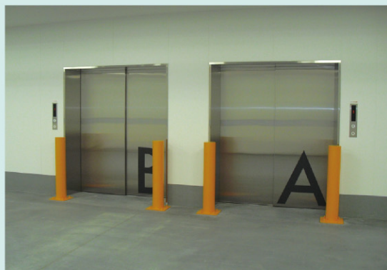
1F 荷物用エレベーター
